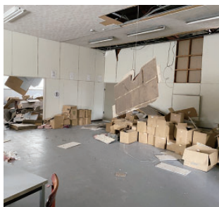
地震により、大きな被害を受けた工場
