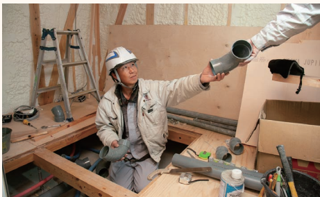
重機を使ったり屋内で配管工事をしたりと仕事はさまざま。
